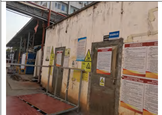
危险废物仓库
