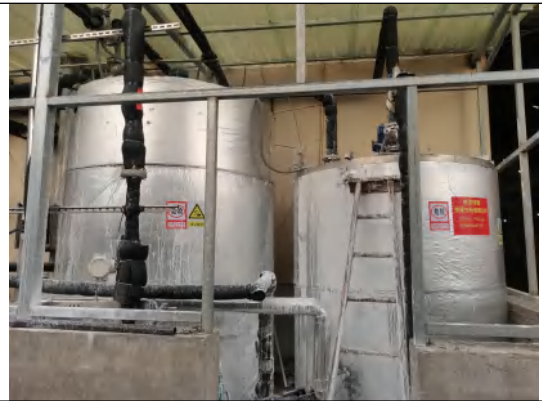
后整理车间门口碱溶剂罐区
