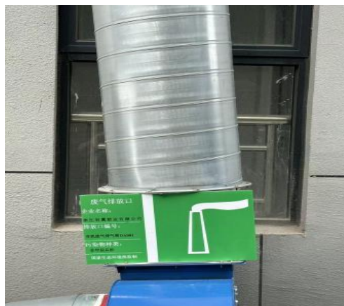
有机废气排气筒 (DA001) 标牌
