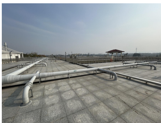
改良 A 2 /O 生化池
