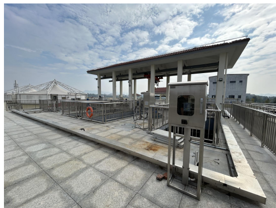
磁混凝高效沉淀池
