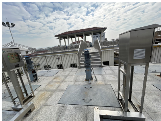
反硝化深床滤池
