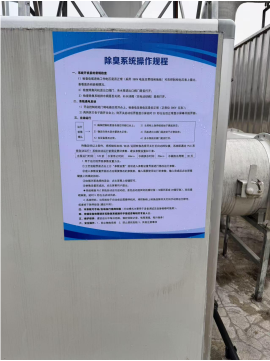
除臭系统操作规程
