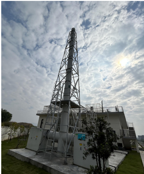
除臭废气排放口 DA002
