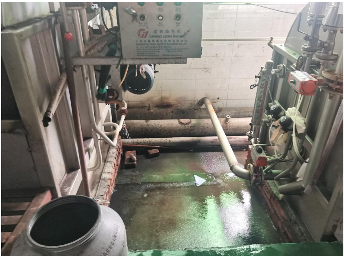
图 4.1.4-5 二楼印染废水收集管道
