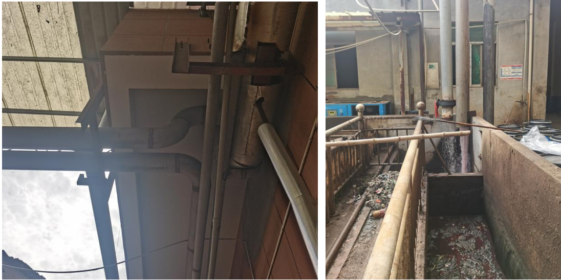
图 4.1.4-7 二楼印染废水管道排放口
