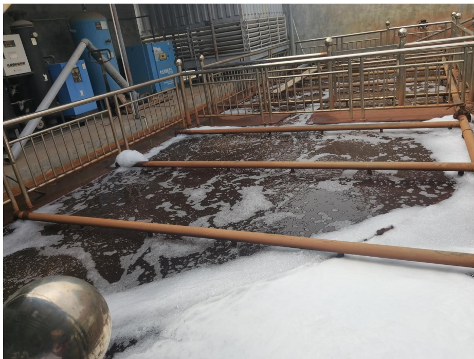
图 4.1.1-5 气浮池（半地下池体，地上高 3m，地下水深 6m）
