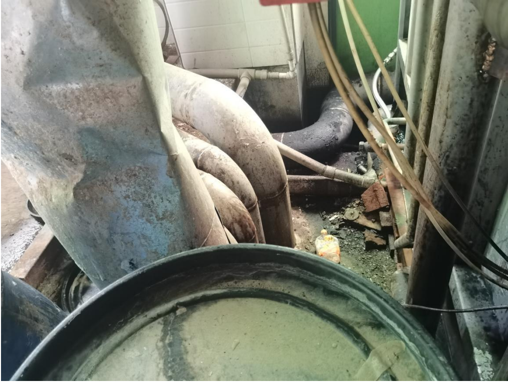
图 4.1.4-6 二楼印染废水收集管道汇总处
