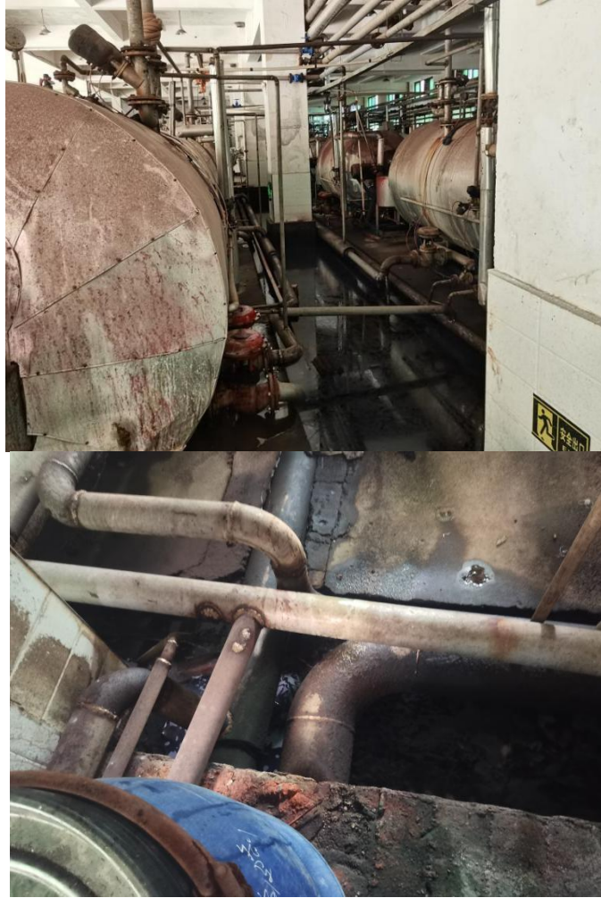
图 4.1.4-2 一楼印染废水导流沟
