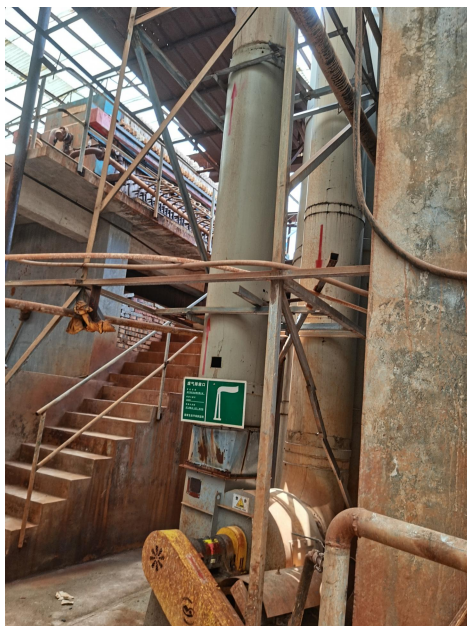
图 4.1.5-2 污水处理站恶臭气体处理设施
