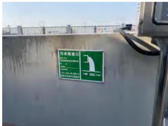
图 4.1-2 污水站和废水排放口现场照片
