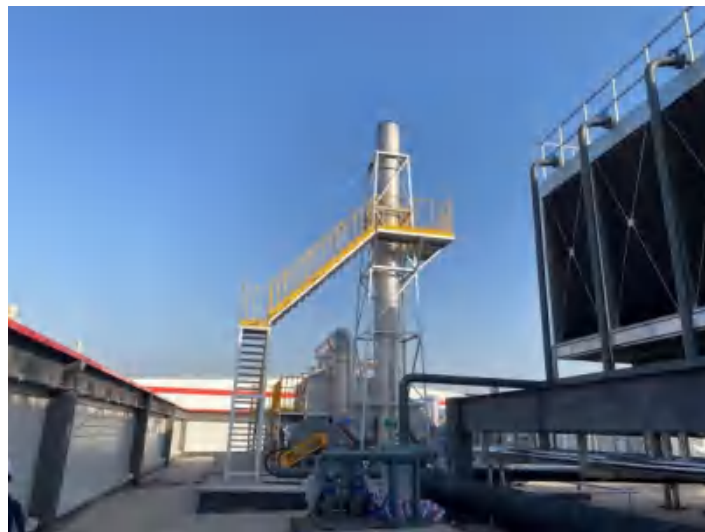
废气处理设施
