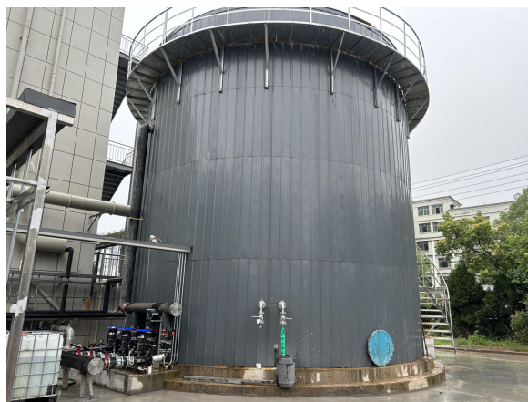
新污水处理站
