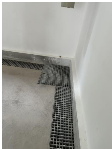
新危废仓库地下收集池、导流沟 (4) 实验室
