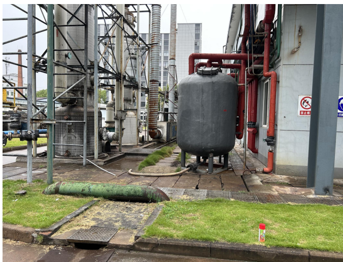
有机废气设施及排放口
