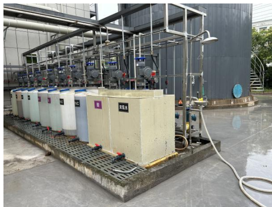
新污水处理站加药区照片
