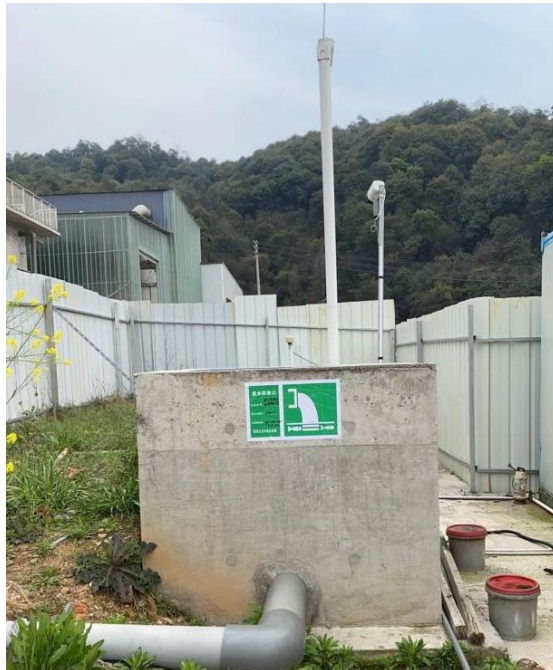
图 4.1-2 污水站和废水排放口现场照片
