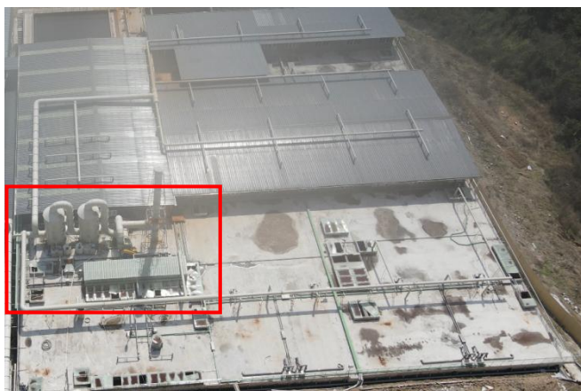
酸洗喷淋+碱洗喷淋处理设施
