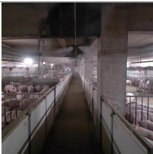
室内喷淋设施
