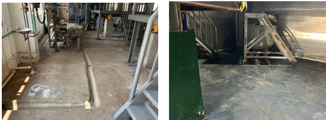
图 4-14 生产车间一生产装置照片
