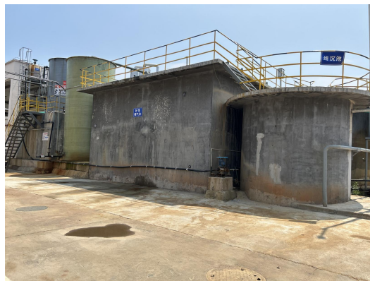
图 4-7 新污水处理站照片
