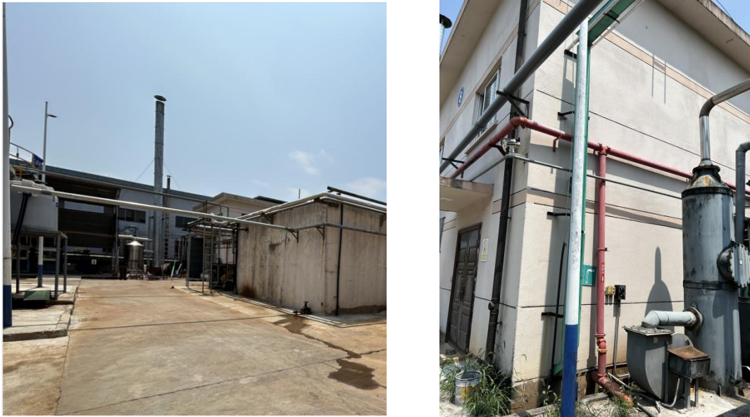
图 4-19 废气治理区照片
