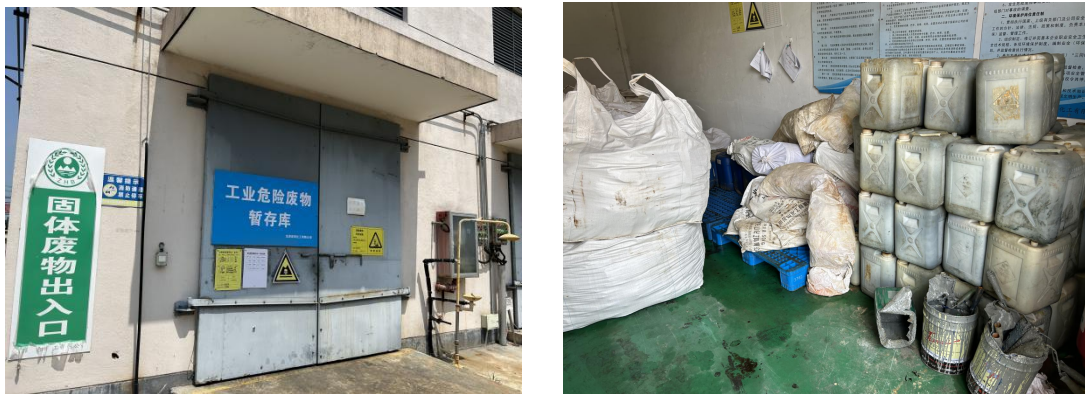
图 4-18 危险废物暂存间照片
