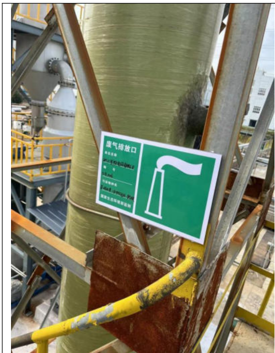
污水站低浓度废气排放口标识
