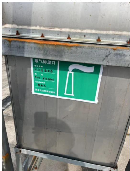
制剂粉尘 3#排放口标识
