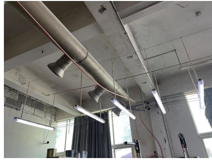
1楼车间印刷工序防护设施
