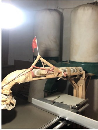
1 楼车间锯板岗除尘设施
