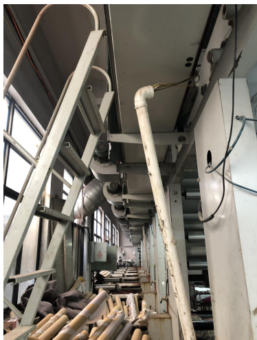
彩印岗局部排风设施
