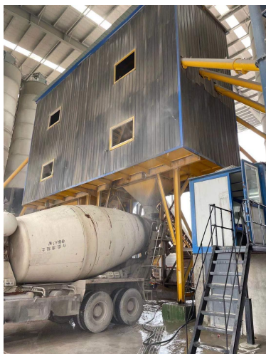
搅拌站喷淋装置
